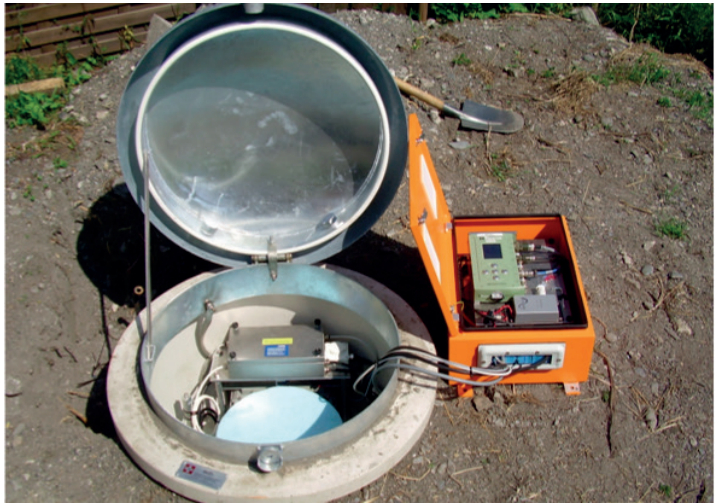
Geöffnete Abdeckung einer Freifeld-Installation
